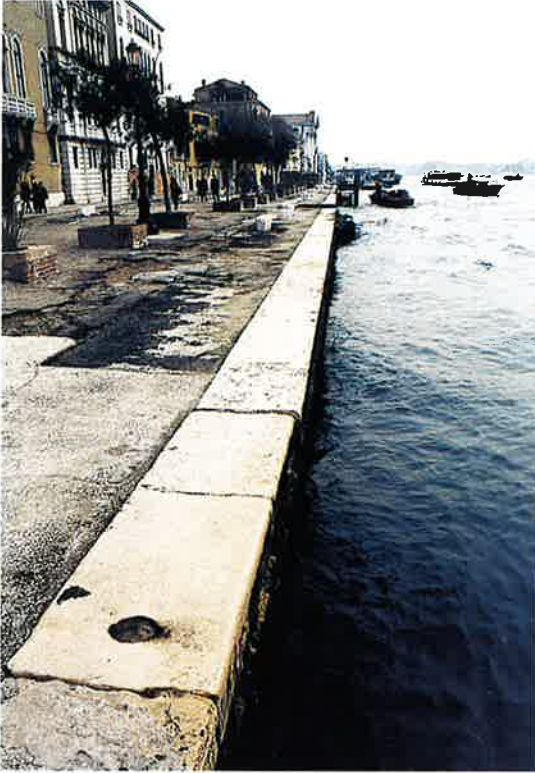
In alto e a destra L'area interessata dalla prima fase degli interventi prima e dopo i lavori e la relativa sezione tipo con i particolari costruttivi della nuova riva
