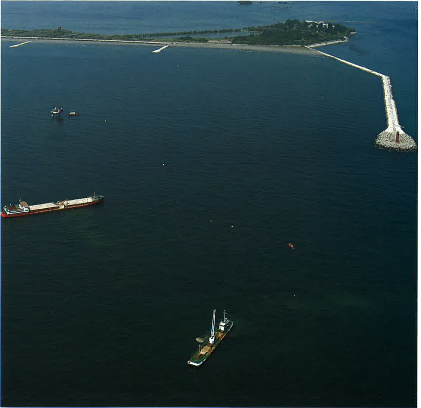
Sistema MOSE. Lavori per la realizzazione della scogliera, a sud della bocca di porto di Malamocco, prevista nell'ambito delle cosiddette "opere complementari"
