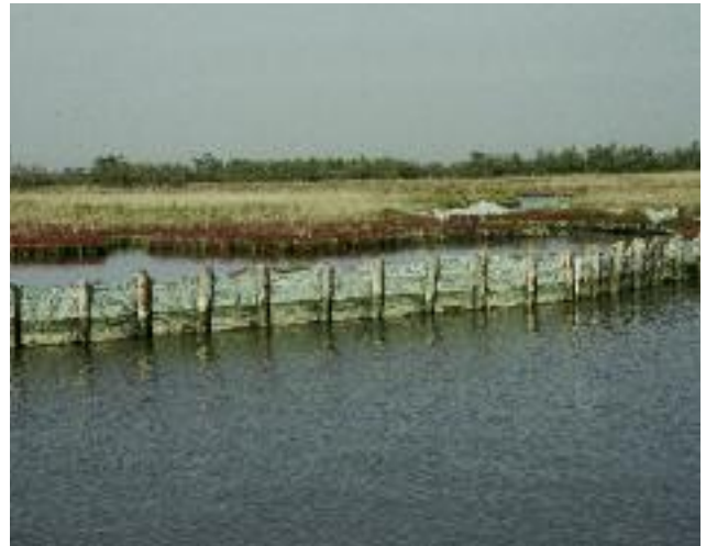
Conterminazione con parete filtrante in pali di legno distanziati per la realizzazione di strutture morfologiche artificiali (barena Del Vigno - Laguna nord)
