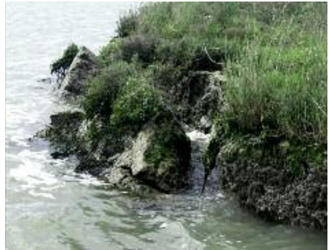
Erosione dei margini bareali con crollo di zolle vegetate (laguna nord)
